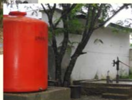
Water Pointと保水タンク 照明設置が設置されている ↓
