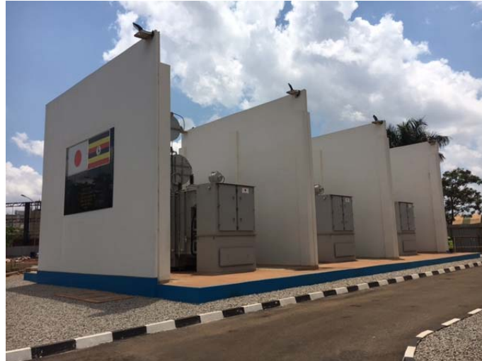
図 3-6 写真: キーンズウェイ変電所
