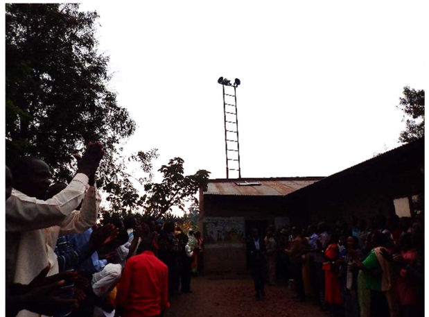
防災能力強化の一環として、早期警報システムを設置した
