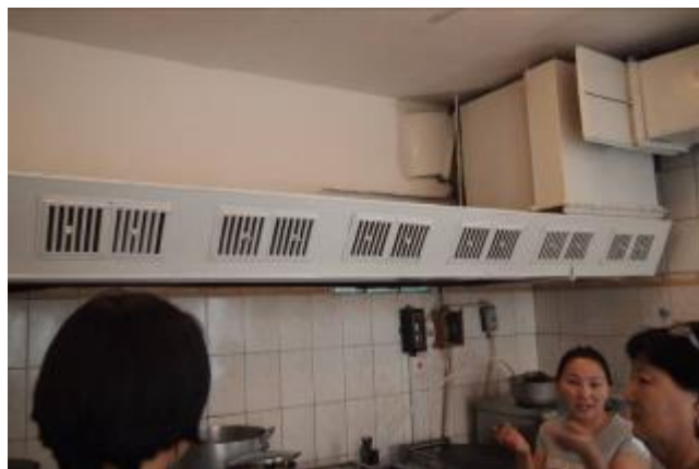
↑ 改修した調理室の換気扇
