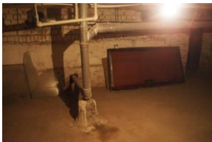
↑ 地下室の改修した配管
