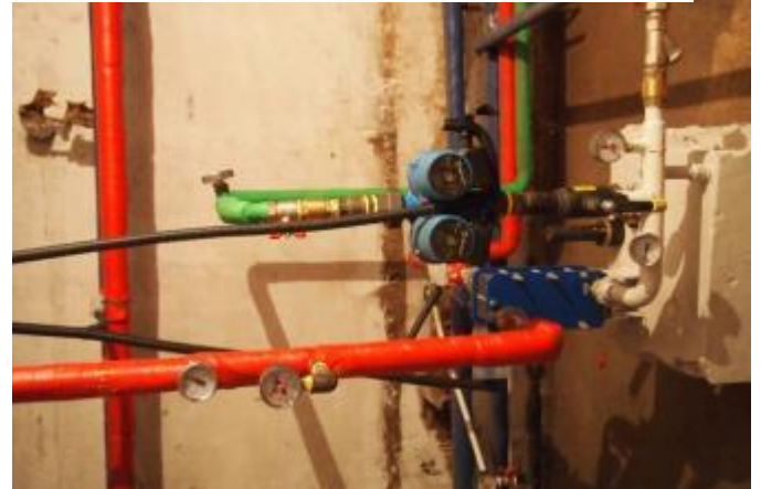
↑ ボイラー室の配管②
