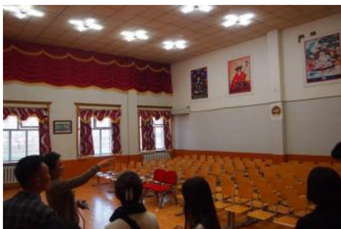
↑ 暖房・換気設備を設置した文化ホール。かつては換気設備がなく、悪臭が立ち込めていたというが、現在は嫌な臭いや煙もなく改善されていた。
