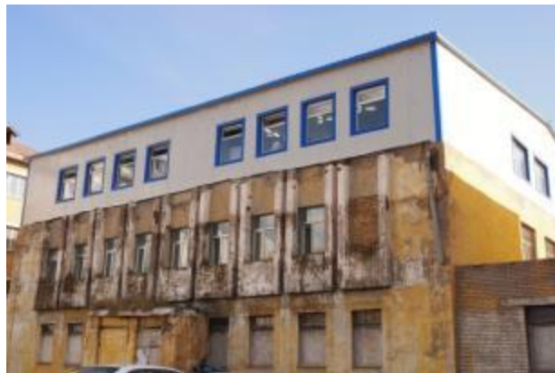
↑ 増築部分(3階部分)2階より下部分の老朽化が見た目にわかり心配である。
