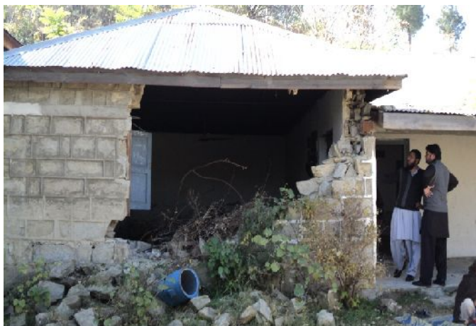
GGPS Chennai Harya 破損校舎
