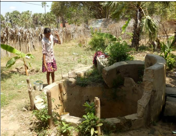
キリノッチ県パッチラパライ郡 Muhamallai 地区 （紛争で破壊された井戸）
