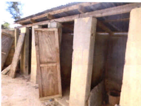
建設前の学校トイレの状態
