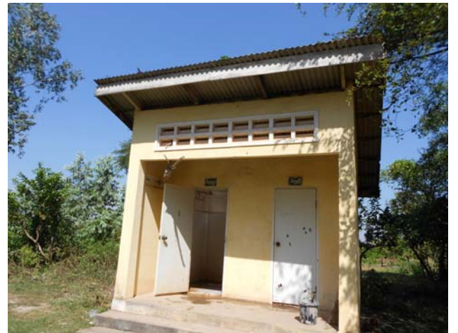
一部壊れ補修が必要な既存トイレ
