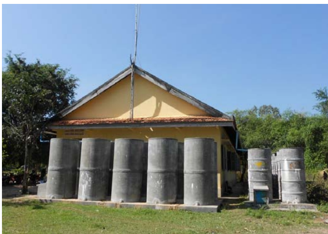
小学校に設置された貯水槽
