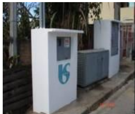
【水量計測設備】
