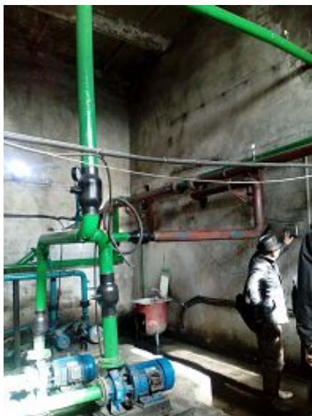
コベネフィット型環境汚染対策調査での 対象第 65 学校の改善ボイラー
