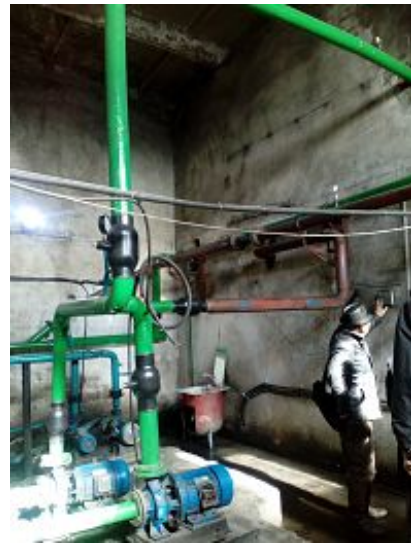
出所: 評価チーム 第65学校の改善ボイラー
