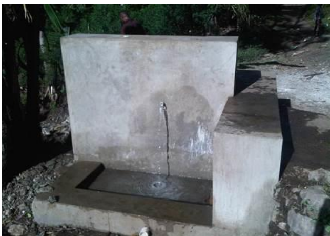
コミュニティの湧水利用の給水システムが修繕され、 使用できるようになった給水ポイント
