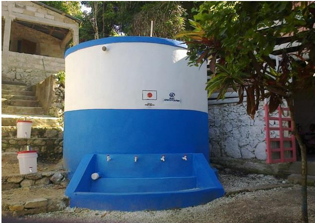
学校に建設された給水設備
