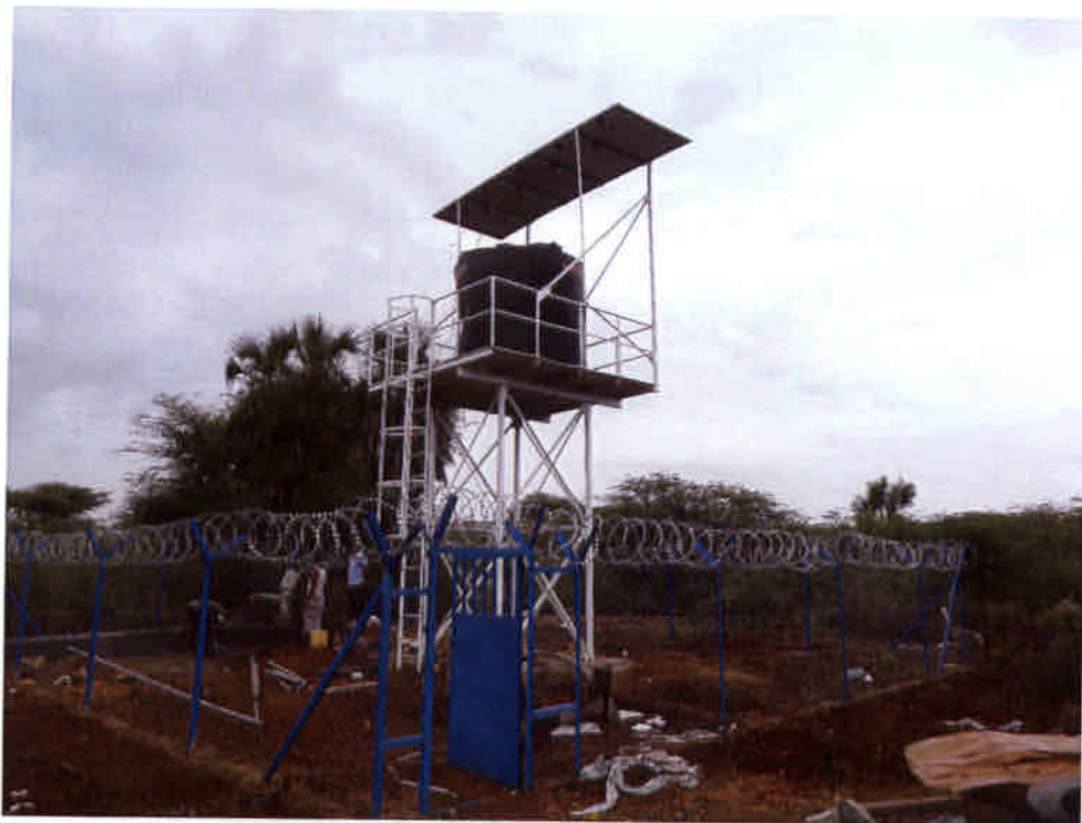
1. 完成した太陽光発電式の給水設備。ソーラーパネル等の盗難を防ぐため周囲にフェンスを設置している。(Jarirrot 村、2014 年 11 月 21 日撮影)
