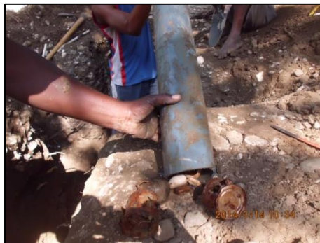
廃棄物が詰まっていた古いパイプ
