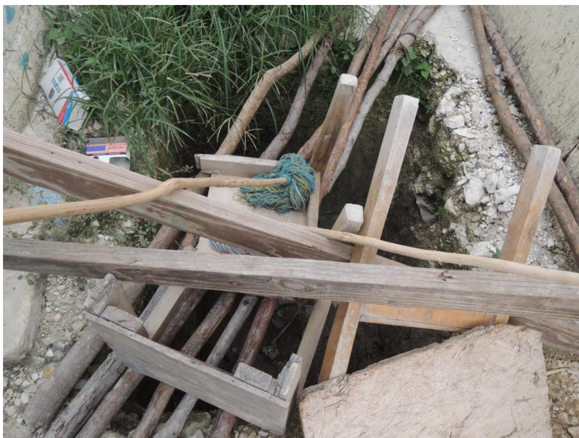
トイレの便槽も掘削途中で放置されている
