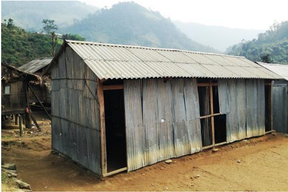
ゾ小学校の仮設校舎。教室は暗く、雨や風の影響も受けやすい。小学校5学年のうち、3学年がこの老朽化した校舎で学ぶ。児童数に対して教室が小さく、机や椅子などの教室備品も不足している
