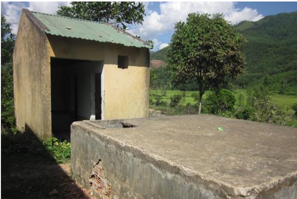
ヌオックラン小学校のトイレ。1998年に建てられ、すでに老朽化しており、水も出ない。衛生環境の悪さは、感染症が蔓延する原因となる
