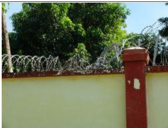
一部壊れたフェンス上部の鉄条網
