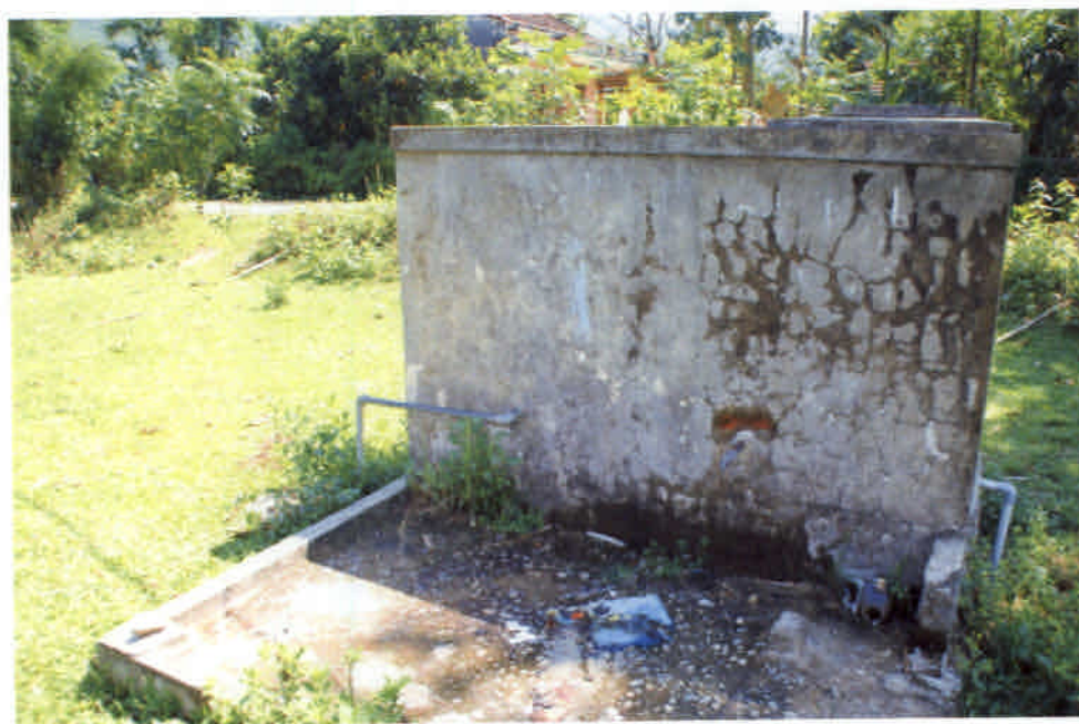
同ランシ小学校の壊れた給水設備。この小学校には幼稚園も併設されているが、子どもたちは水がない環境で学校生活を送っている。当事業では井戸の掘削を行い、子どもたちが衛生的に学校生活を送れることを目指す
