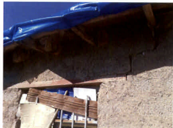
基礎工事がされていないため、壁に大きな亀裂が入り、倒壊の恐れがある
