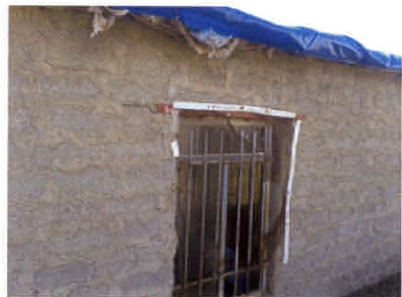
こちらの教室の窓ガラスは半分割れており、壁には亀裂が入っている
