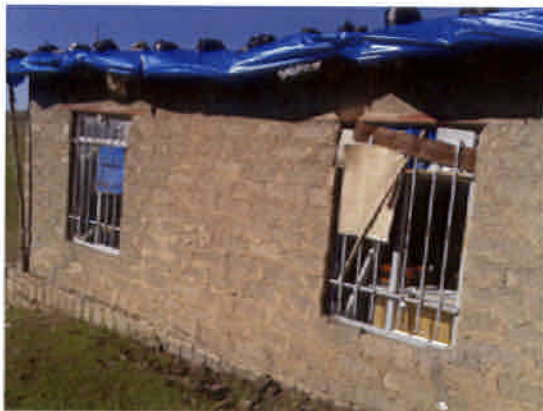
窓ガラスが割れているが、修繕予算がないため、代わりに段ボールなどを使用している
