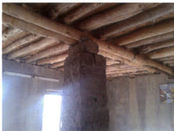
天井倒壊を回避するため、教室の中心にコンクリートブロックを積んでいる
