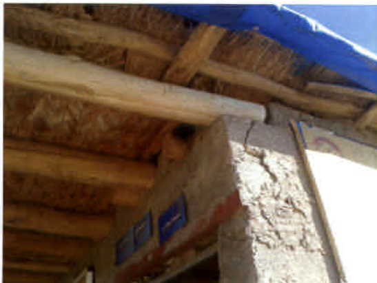
壁には亀裂が入り、屋根が木材と土でできているため、雨季になると雨漏りに悩まされる。また、天井にできた穴から毒蛇が入ることもある。
