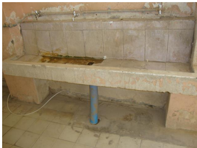
きれいで安全な水が出ない手洗い場。長年機能を失ったまま、修繕がされていない
