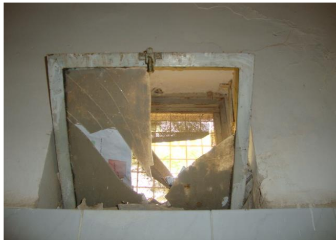
壊れた窓ガラスで手を切ってしまう危険性がある
