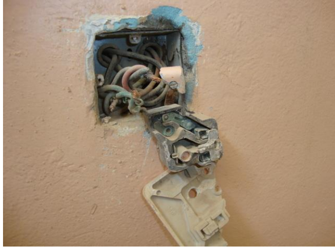
壊れた電気設備で感電する危険性がある
