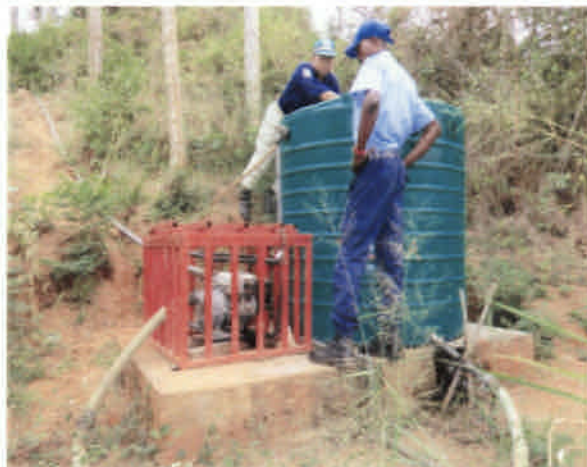
中継点のタンク・ポンプの点検
