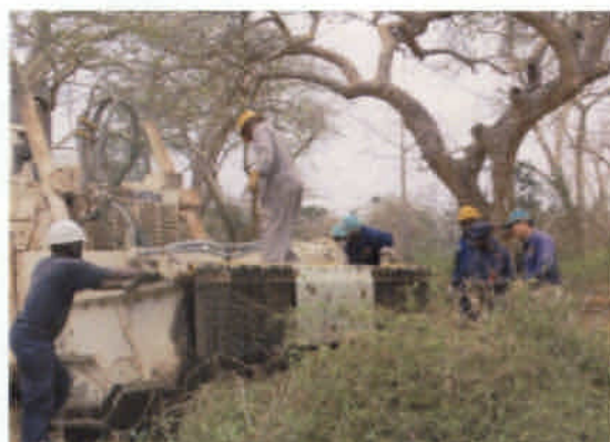
除去中のトラブル対処法を説明する専門家
