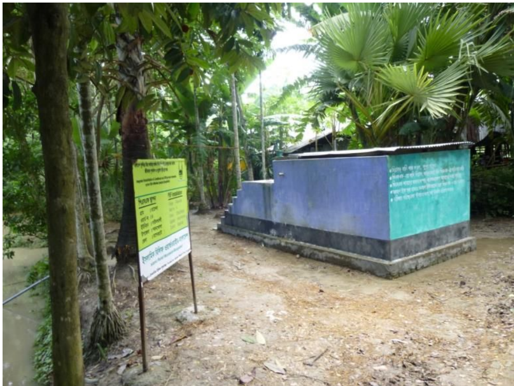
③ 飲料水源として利用されている池の側に設置された PSF (ポンド・サンド・フィルター)
