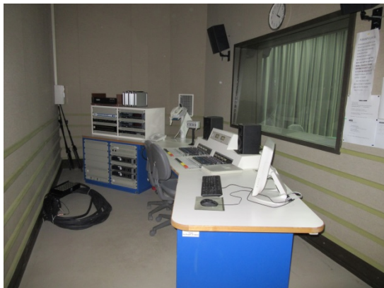
無償資金協力により整備された 中波放送局の設備 (ツバル)
