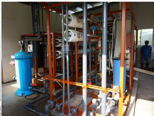
PEC 基金を活用して整備された 海水淡水化プラント (ツバル)
