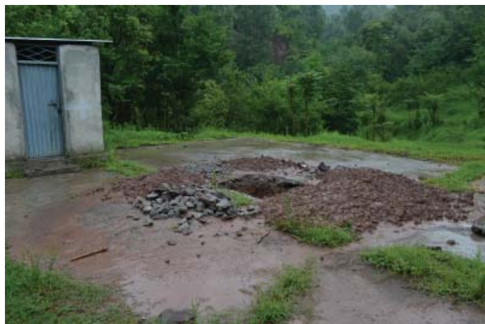
GGPS Gohri Syedian 再建予定地 緊急支援で立てられたトイレ(左)も劣化が進み、 現在は使用されていない
