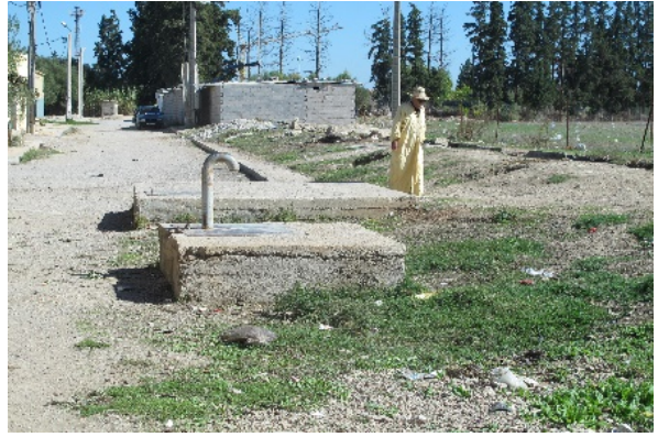
モロッコの地方部のコミュニンに設置されているセプティックタンク
