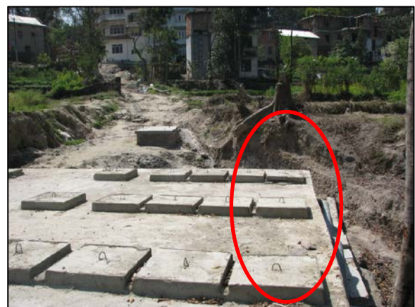
ABR（右側）（出口）の様子
