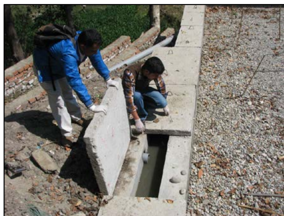
ABR 処理後の汚水が人工湿地に行く前
