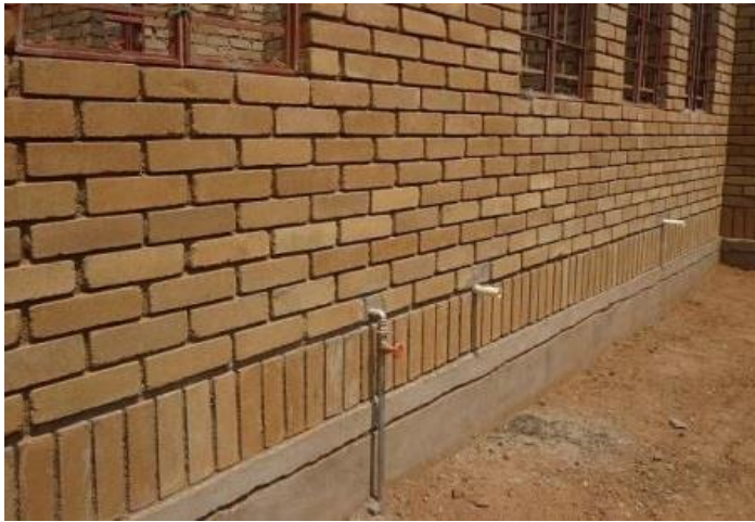
水道用の配管状況 2013 年 9 月
