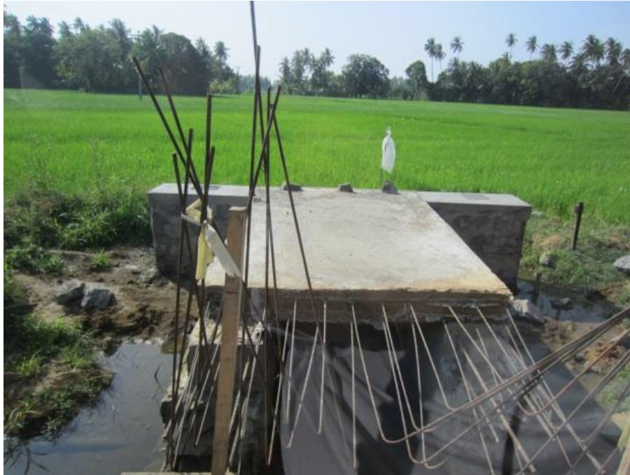
④ 洪水で壊れたままの橋
