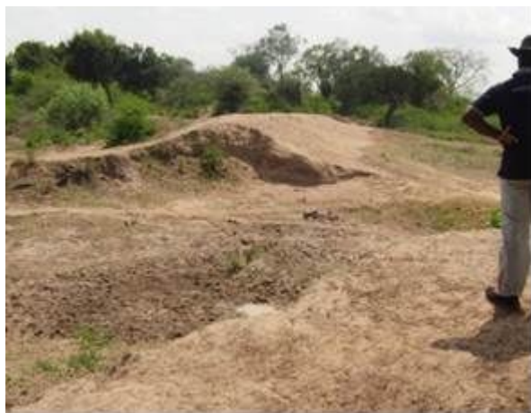
作業開始前（決壊箇所）
