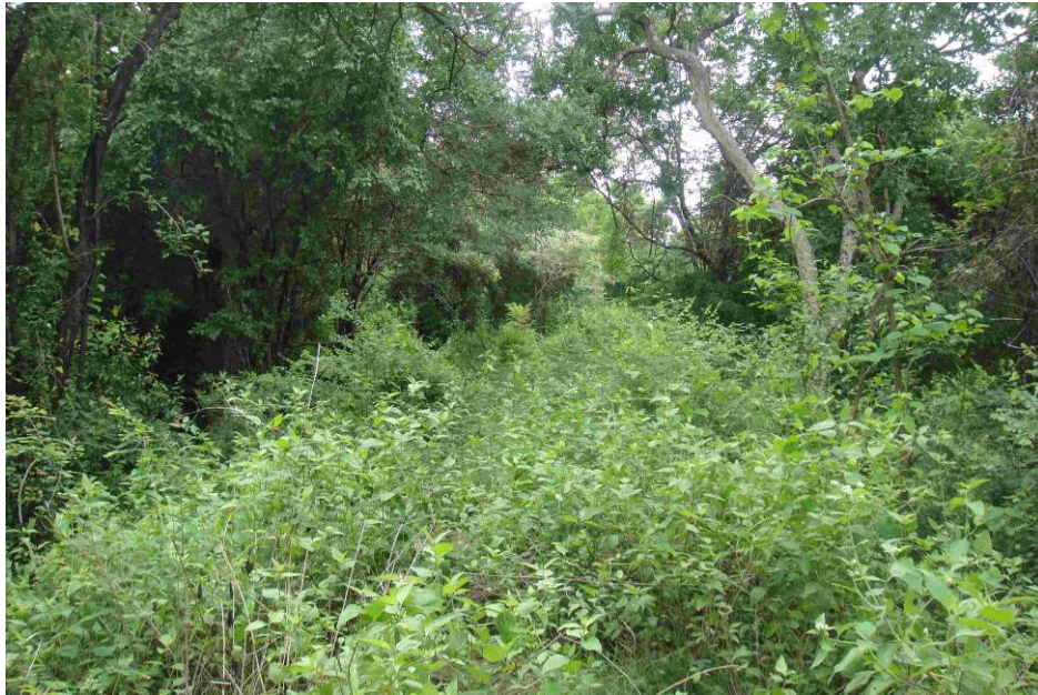
ジャングル化し荒廃した堤防 (ゴマランカダウェラ郡キウラカダウェラ村クダハラパウェア貯水池)
