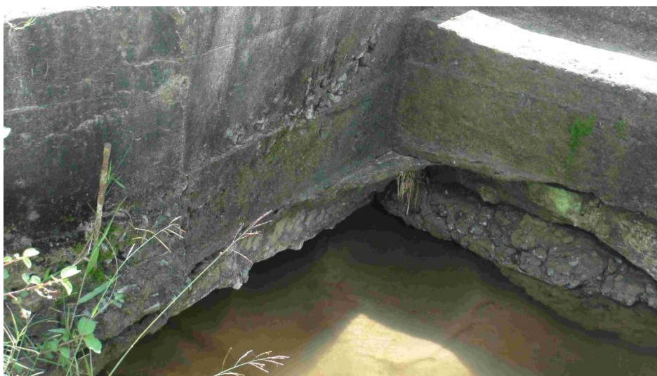
漏水している放水壁 (カンタレ郡ヴァーネラ村コーンガスウェア貯水池)
