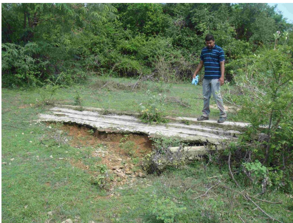
破損した放水壁 1 (ムトゥール郡チェナイユール村マイルマリクラム貯水池)
