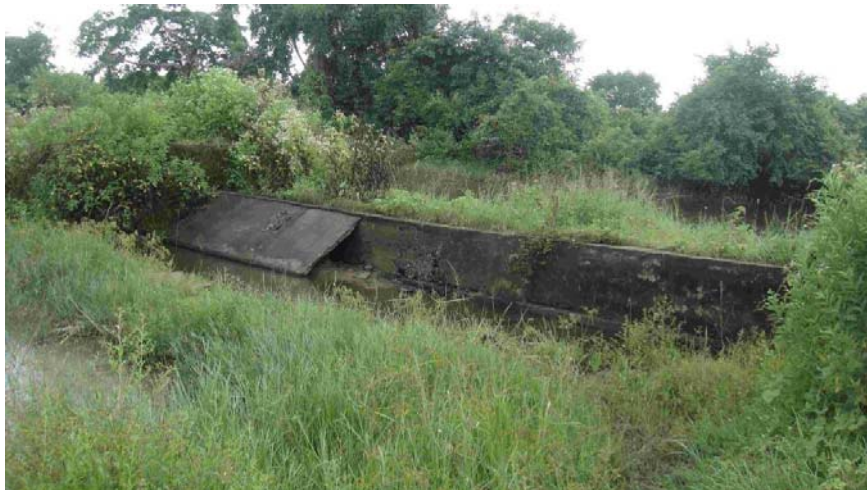
破損した放水壁 (カンタレ郡ヴァーネラ村ミーガスウェア貯水池)
