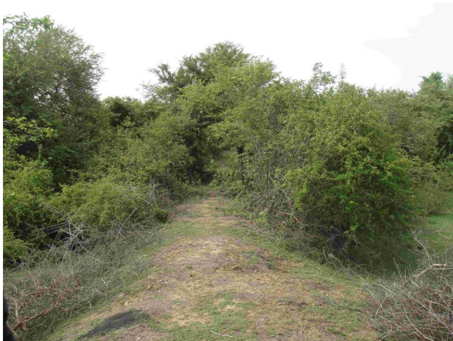
荒廃した堤防 (ムトゥール郡チェナイユール村マイルマリクラム貯水池)
