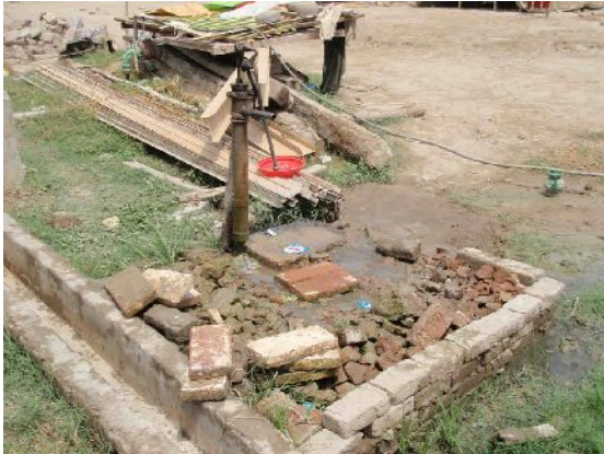
洪水により破損した井戸。
