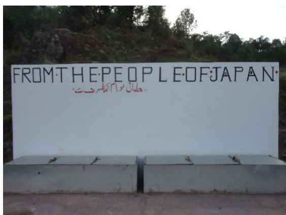
完成したメインタンク
