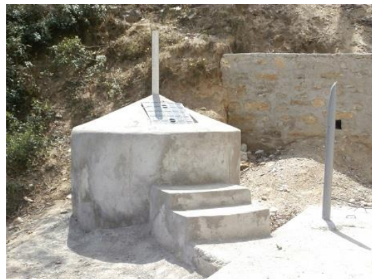
バワニ VDC 胎盤廃棄処理施設 各お産センターに 1 基ずつ、写真のような胎盤廃棄処理施設を設置した （2013 年 3 月撮影）
