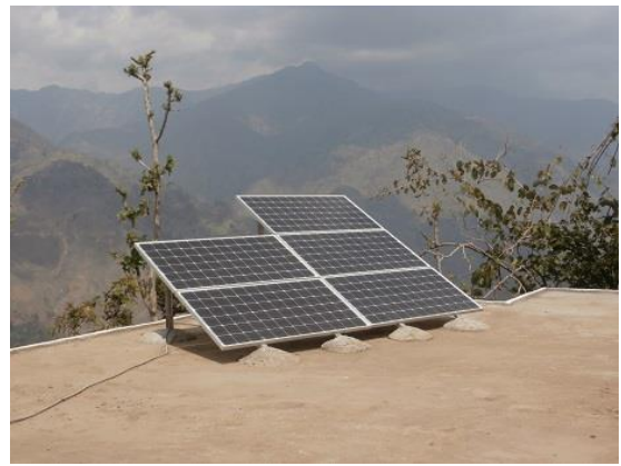
チャムンダ VDC ソーラーパネル 建物内には 950 ワット分の電力が蓄電できるバッテリーも提供。夜の出産に対応できる上、電力で稼働する医療機器も使えるようになった（2013 年 3 月撮影）
