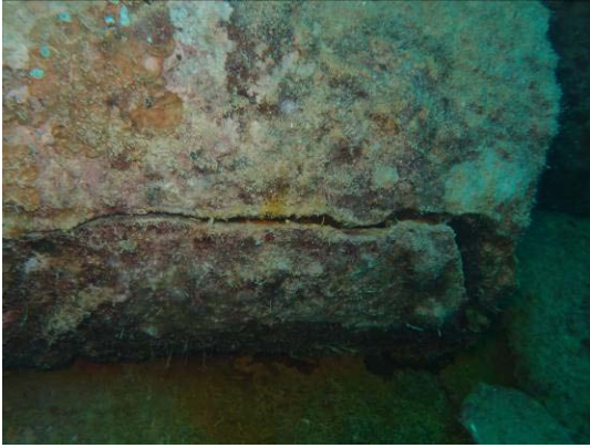
亀裂から漏洩するピクリン酸
