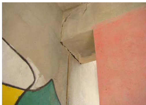
つなぎ部分のひび割れがひどく、 倒壊の危険がある
