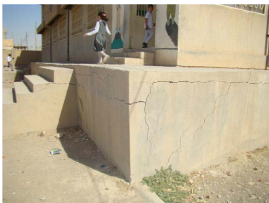
校庭に行く際に生徒が使う階段であるが、 ひび割れがひどく倒壊の危険あり
