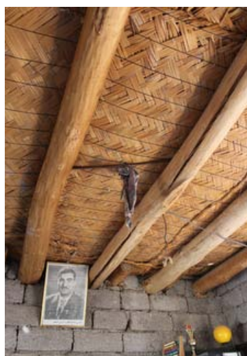
天井の穴からは雨漏りするので、 それを止めるため、布を入れている
