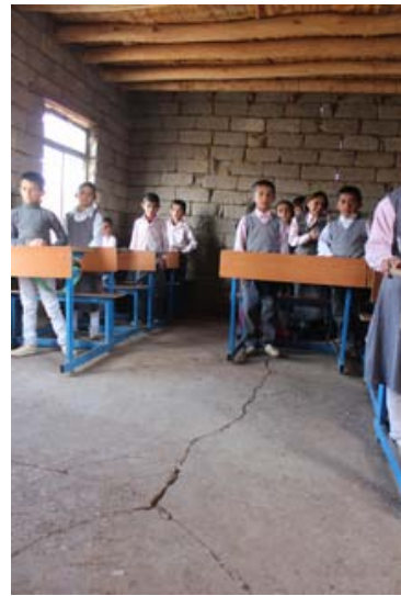
基礎工事がされていないため、 床にはひびが入っている
