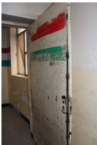
教室のドアの破損（このドアの割れ目辺りを持っていたとき、突然強風が教室の窓から入りドアが閉まってしまい、大けがをした生徒がでている）
