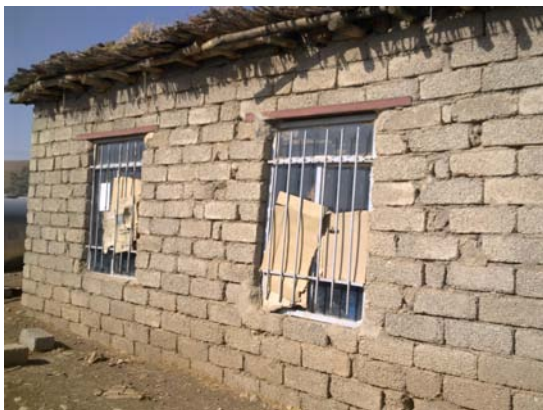
窓ガラスが割れているが、新しい窓ガラスに かえることができないため段ボールを入れている
