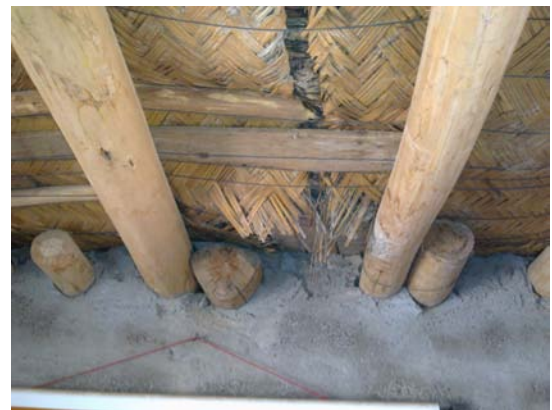
天井が壊れ、倒壊の危険がある
