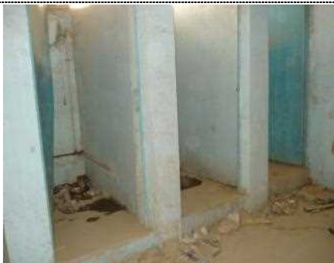
2. Qibaa 中学校のトイレ設備（事業前）
