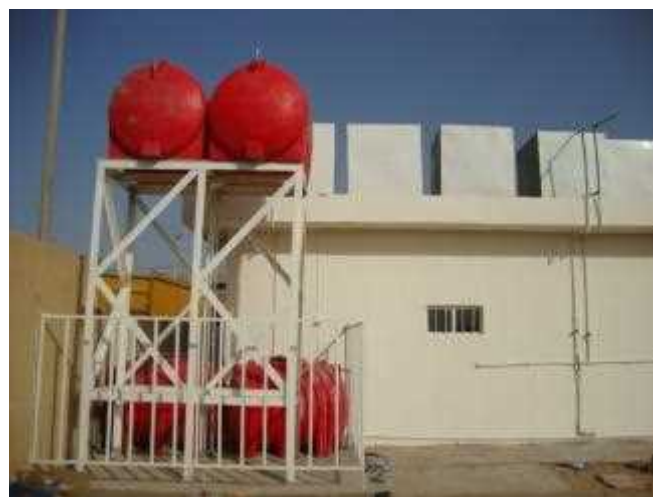
3. Al Hawraa 小学校の新しい給水タンク (事業後)
