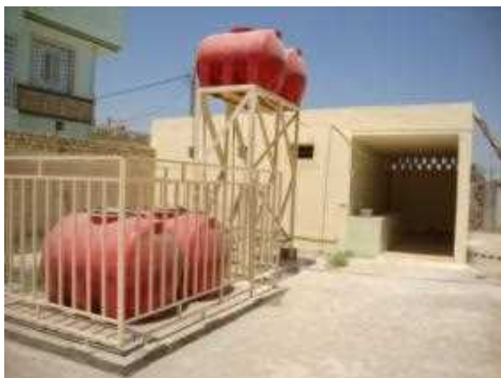
6. Ibn Hayan 女子中学校の新しい給水タンク
