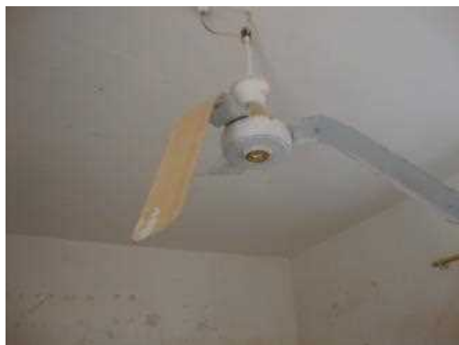
3. 羽が折れ曲がり使用不可能となっていた天井ファン (Al Hawraa 小学校)
