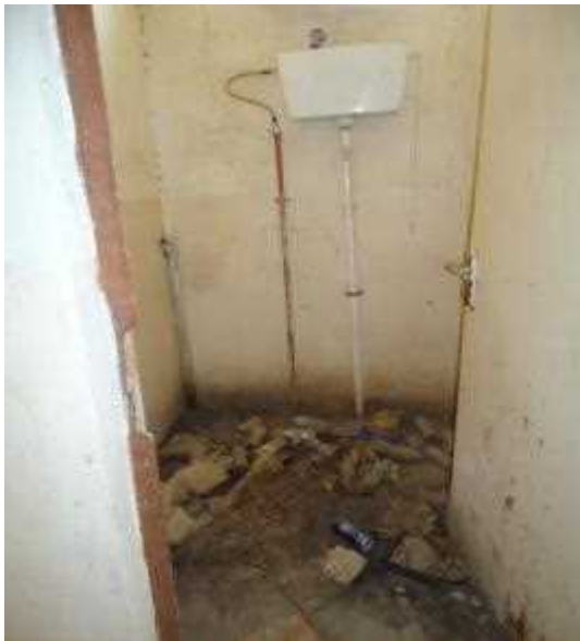
9. Al Shurook 女子中学校のトイレ（事業前）
