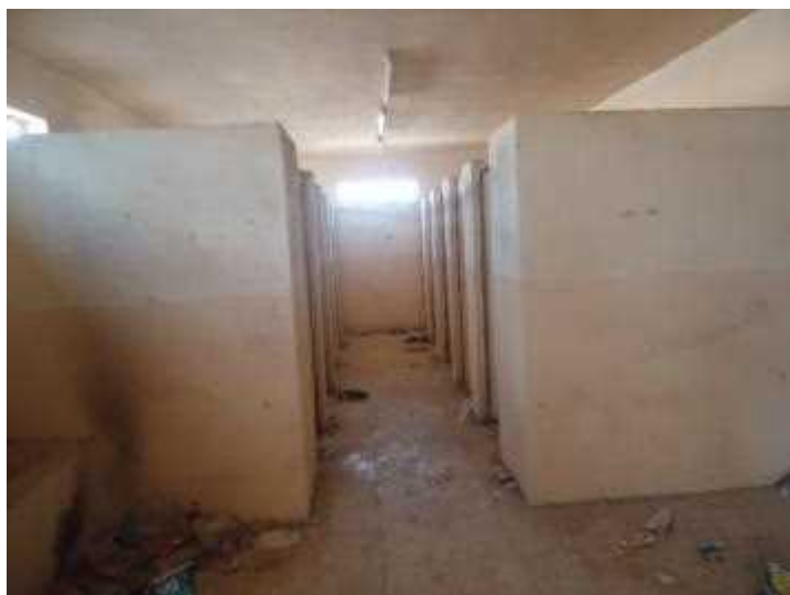
10. Omar Bin Al Khataab 中学校のトイレ施設（事業前）
