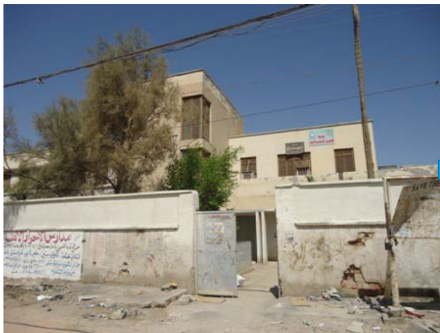
修築前の学校正門。写真右下部のように、塀の多くの部分が壊れ、内部の煉瓦が崩れ落ちているところもあった。
