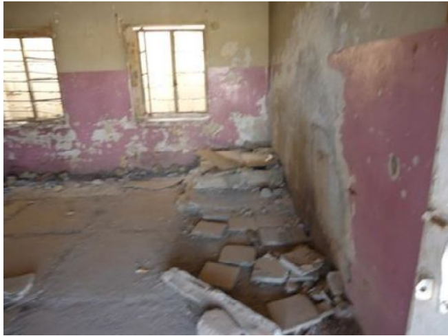
修築開始前の教室。壁表面の塗装だけでなく、壁内部が欠けてしまっているところもある。また、窓枠・窓ガラスは壊れ、床のコンクリートタイルもほとんど剥がれてしまっている。
