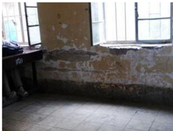
教室の壁はコンクリートが剥がれ落ちるなど、老朽化。
