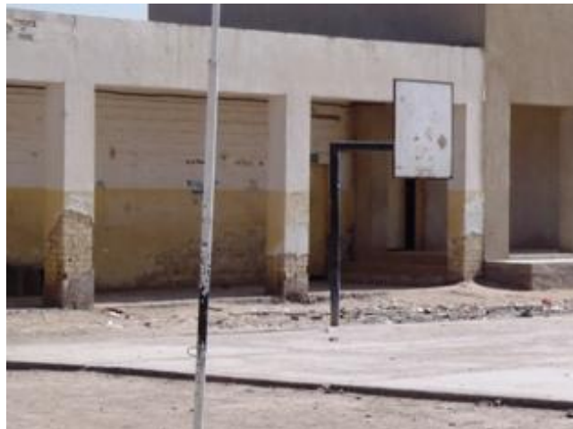
校舎の柱は老朽化し、内部がむき出しになっている。
