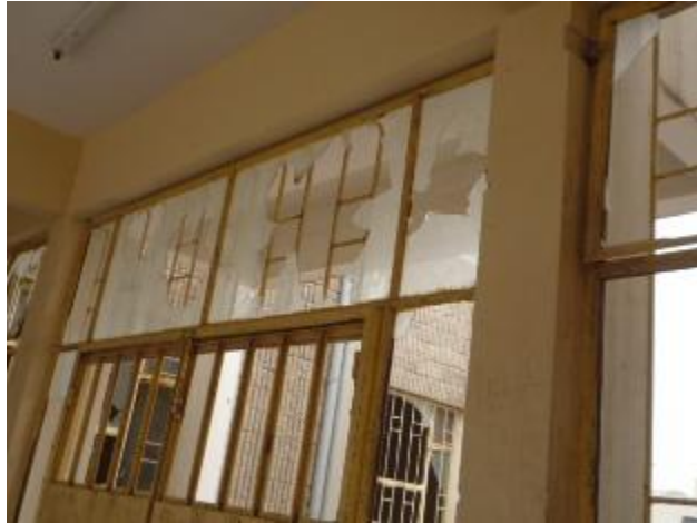
窓が割れたまま放置されている。機能面だけでなく、安全面でも問題がある。
