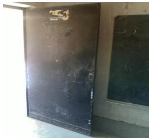
修復前に壊れている教室ドアの状態を 確認 (8月28日撮影)
