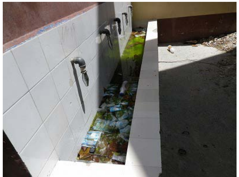
手洗い場の様子：ごみが詰まっている。
