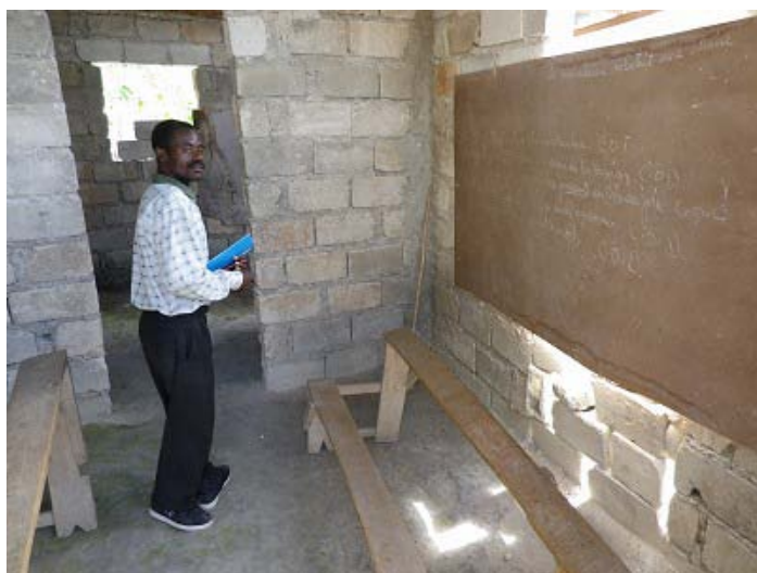
教室の様子：ドア、窓、門がない。
