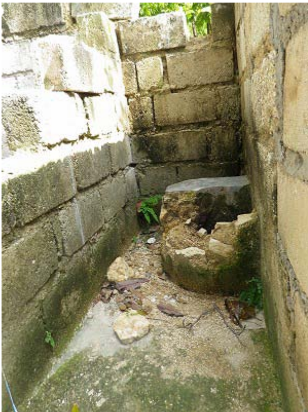
学校にトイレがないため、隣家のトイレを使用。 破損が目立つ。
