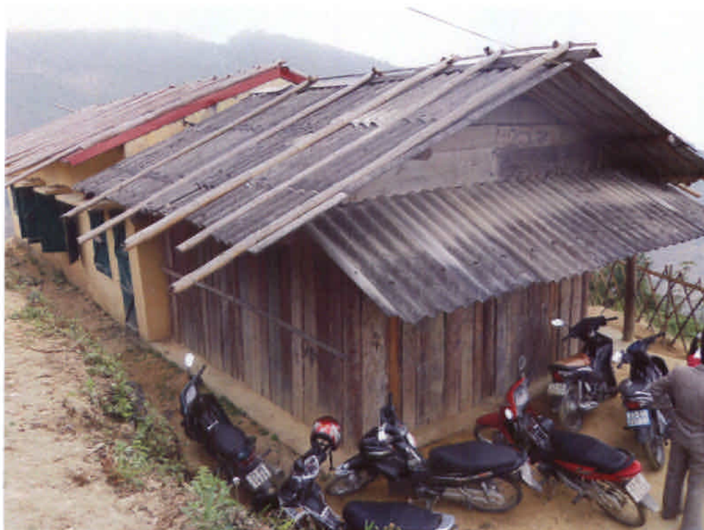
老朽化した木造の教室。悪天候の日には雨漏りのため休校とせざるを得ない
