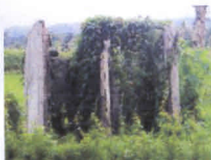
壊れたトイレ
