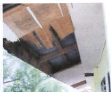
崩落している一部の屋根
