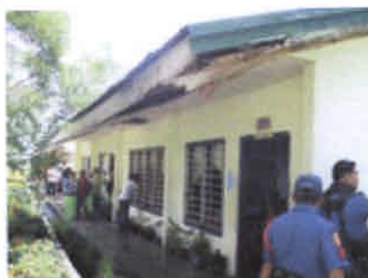
至る所が壊れた校舎
