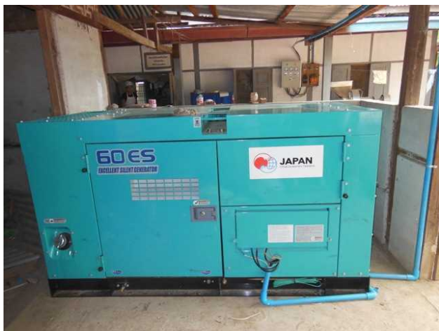
【機材の更新】停電時に利用する発電機
