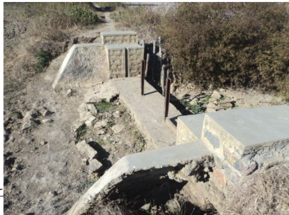
壊れた放水口からは水が漏れ出してしまう
