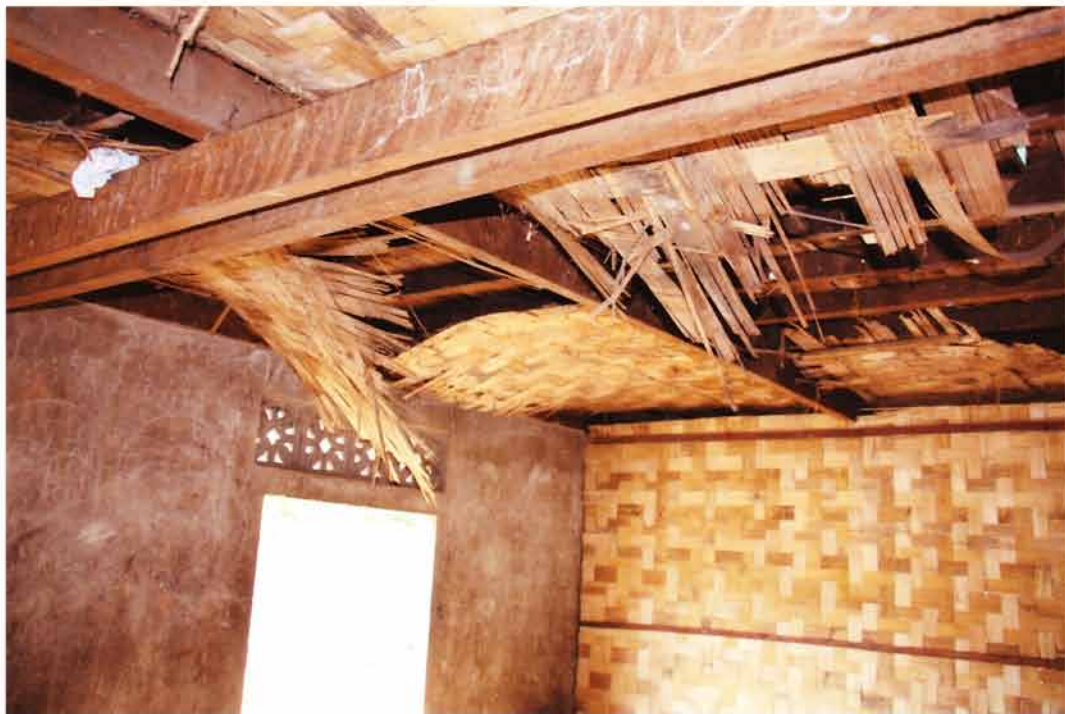
既存校舎1階教室(西側)天井
