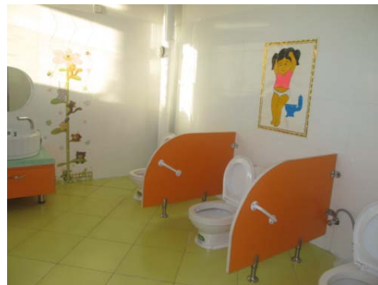
ハンオール地区第121番幼稚園（改修後）2012年12月 子どもサイズの便座と体を支えるハンドル
