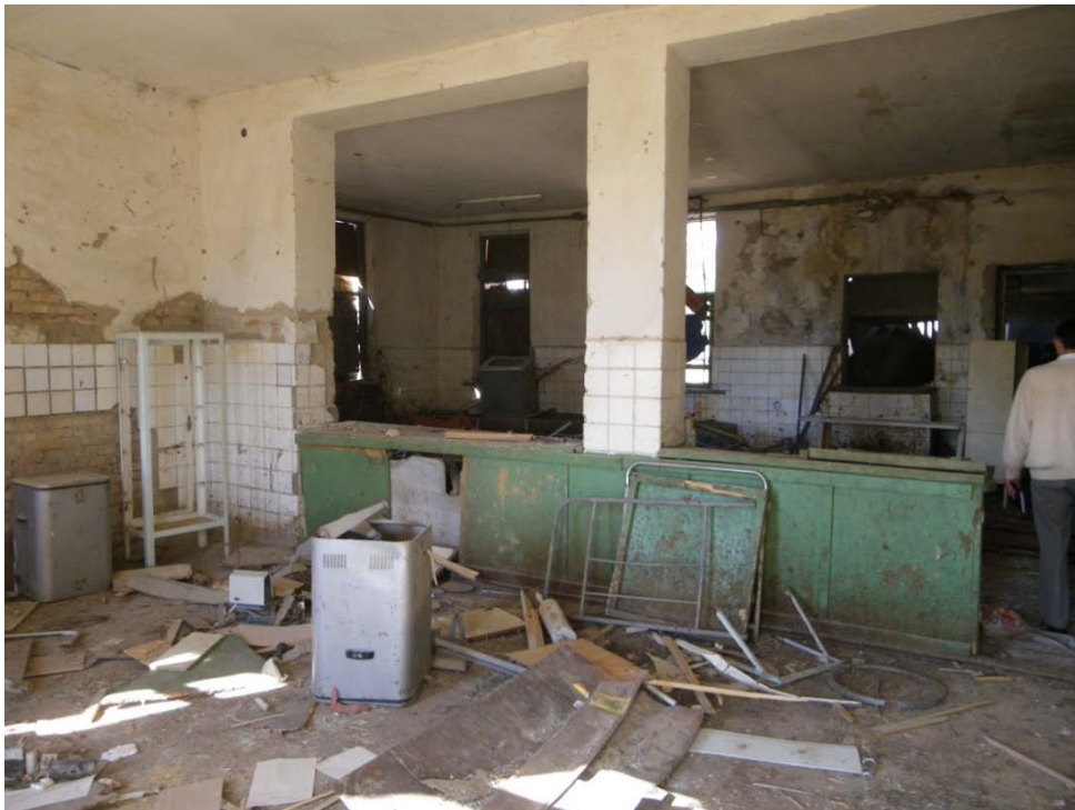
写真2 上記建物の内部。内壁もはがれ落ち、一部雨漏りが発生している。また、廃材や壊れた機器などが散乱している。
