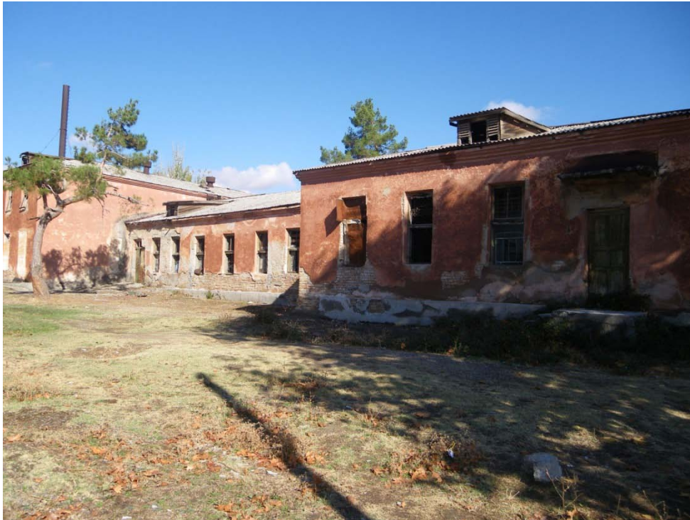
写真1 国立バフダット小児リハビリテーションセンターの改修予定の建物(外観)。現在は使用されていない。外壁の塗装は、はがれ落ち、窓枠も壊れている。
