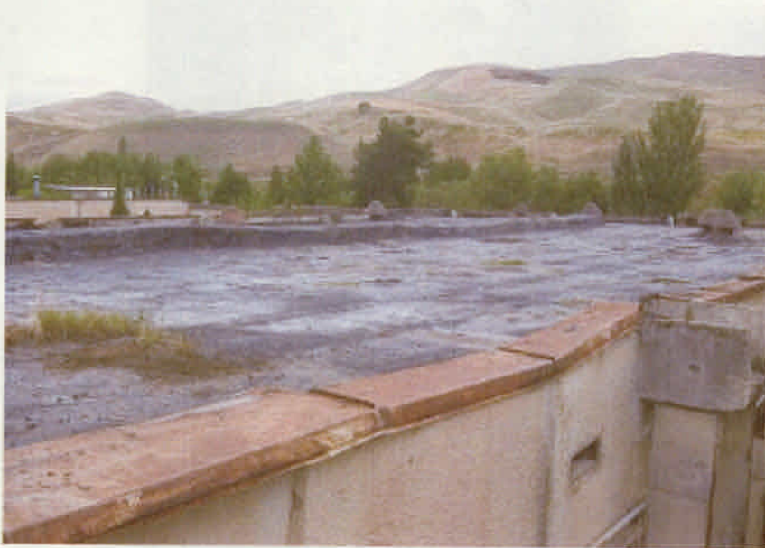
寄宿舎学校外観： 屋上の老朽化により、雨漏りが続いている
