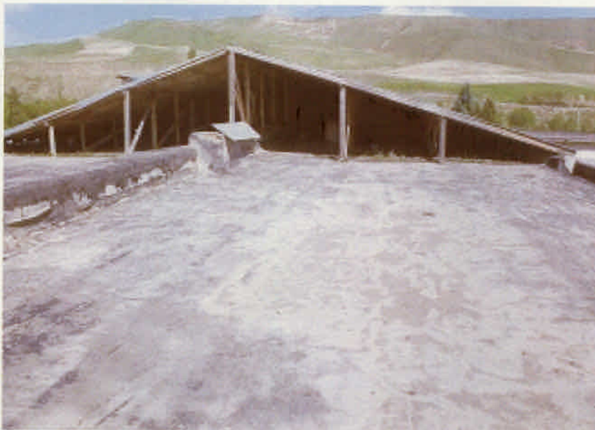
寄宿舎学校外観： 雨漏りを防ぐためには、屋上全体の修理が必要な状態にある
