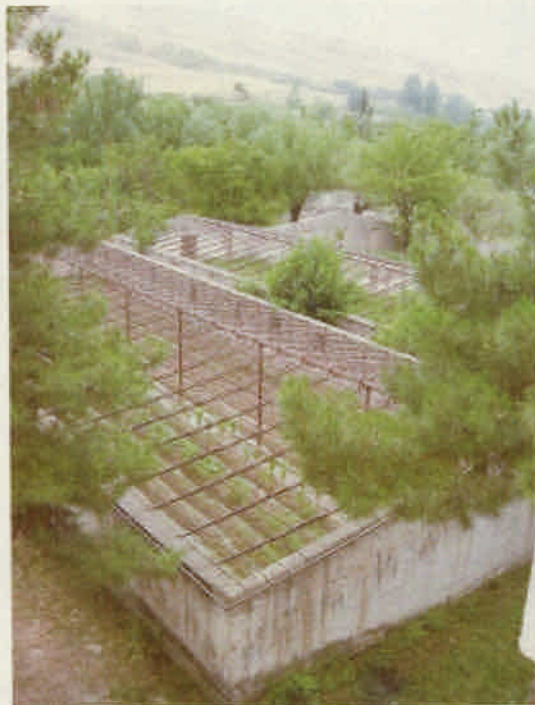
寄宿舎学校温室外観： 旧ソ連が崩壊した後、温室の修繕は全く行われていない
