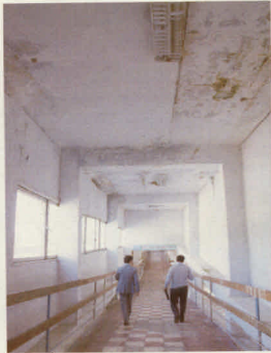
寄宿舎学校内部： 学校内部では、いたるところに雨漏りが見られる
