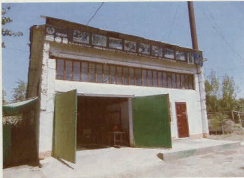
車いす工房外観： 建物全体の老朽化が著しい
