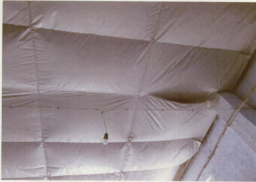
車いす工房内部： 天井のシートが破れて、雨漏りの原因となっている
