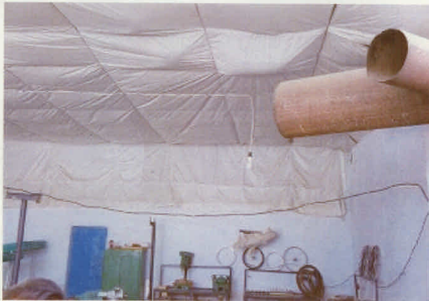
車いす工房内部： 天井からの雨漏りにより、工具類の老朽化も進んでいる
