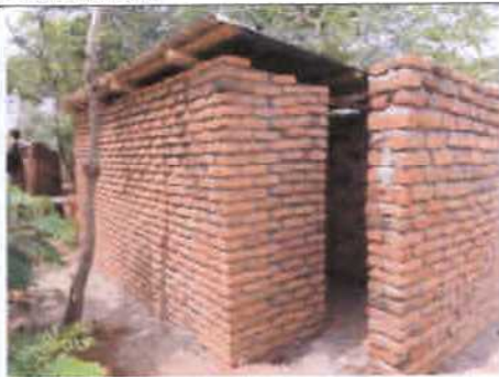
【写真9】チンバール中学校女子生徒用トイレ（小便専用）
