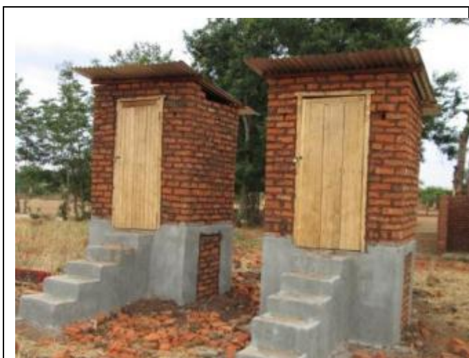
【写真 7】チンバール中学校に建設したエコサントイレ
